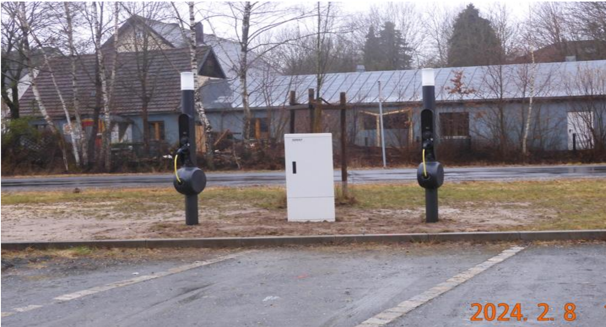
2 Ladesäulen am Bahnhofsparkplatz
